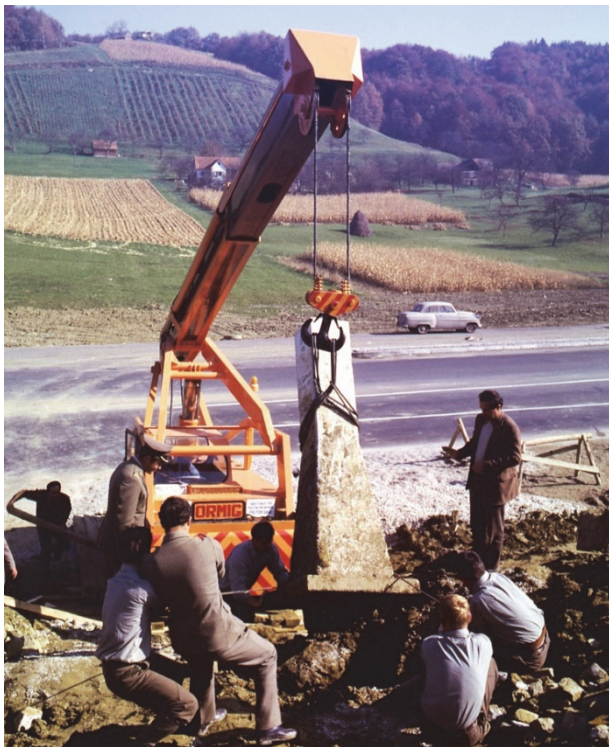
Abb. 10.2: Versetzen des Grenzsteines VIII/72 an eine neue Stelle wegen Verbreiterung der alten Straße Graz-Marburg; auf diesen Grenzsteinen der Type A ist, außer der Nummer, der Hinweis „St. Germain 10. Sept. 1919“ angegeben (Foto: H. König, 1972)
